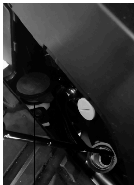
副水箱注入口
